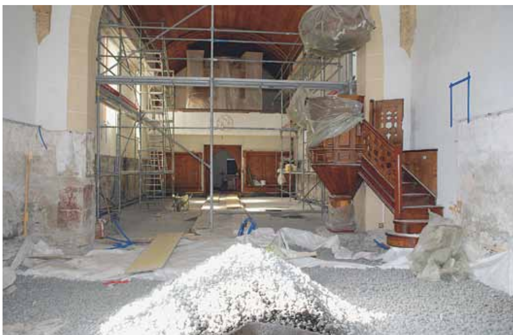
Abb. 6: Tamins, evangelisch-reformierte Kirche. Renovation 2010/11. Die Betonplatten links und rechts des Mittelganges im Schiff sind gegossen. Im Chor wird die Dämmschicht aus Glasschaum (Misapor) aufgetragen, bevor der Betonguss folgt. Blick gegen Westen.
